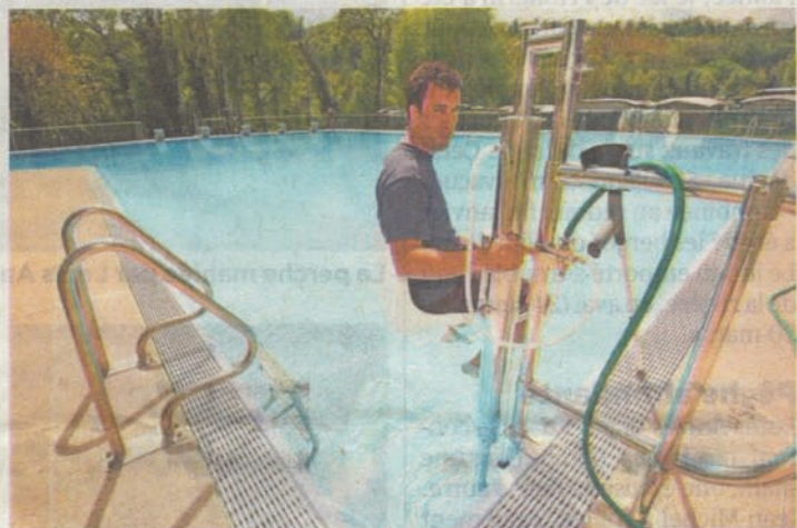
La piscine est équipée d'un lift qui facilite l'accès à l'eau pour les personnes à mobilité réduite. FLORIAN CELLA
